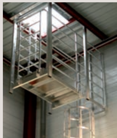
Crinoline et passerelle intérieures pour accès en toiture
