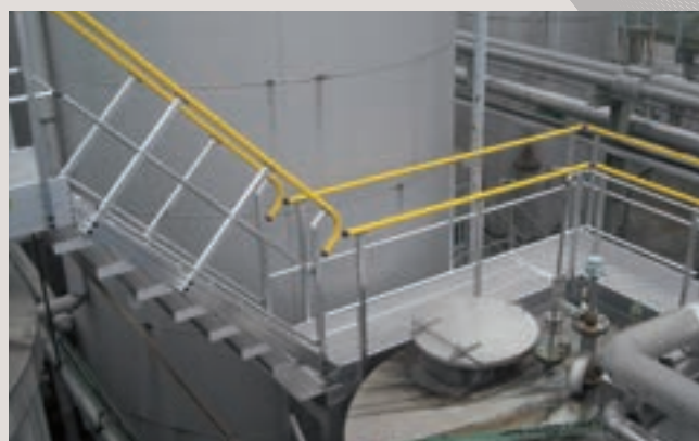
Escalier, passerelle en milieu pétrochimique
